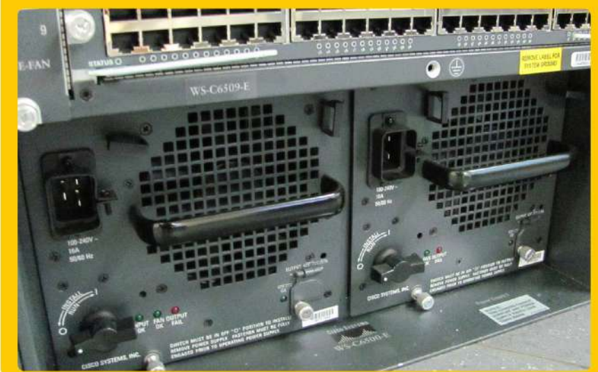
ภาพที่ 4 แสดงอุปกรณ์ระบบจ่ายไฟภายในแบบสำรองของ Switching Hub
